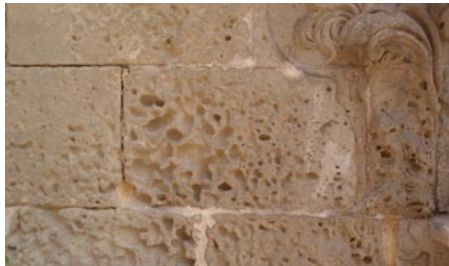
figura 24 - Detalle del proceso de alveolización que sufren las rocas de la fachada de la iglesia de Santa María. Compárese con la figura 18.
