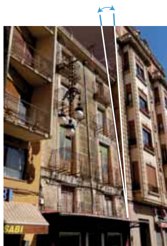
figura 37 - Edificio basculado en Plaza Nueva (Orihuela), situada en las proximidades del río Segura.
